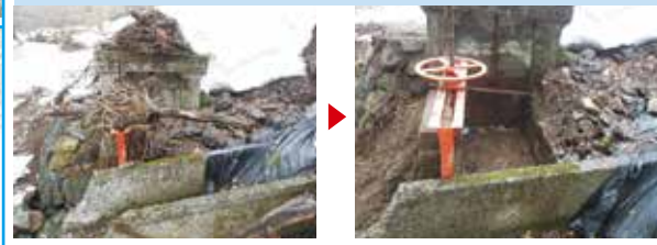
白玉堰（取入口破損、水路土砂閉塞）
