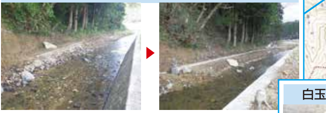
姥ヶ沢第四堰（取入ゲート全損、水路土砂堆積）
